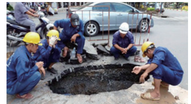
ホーチミン市内での道路陥没
